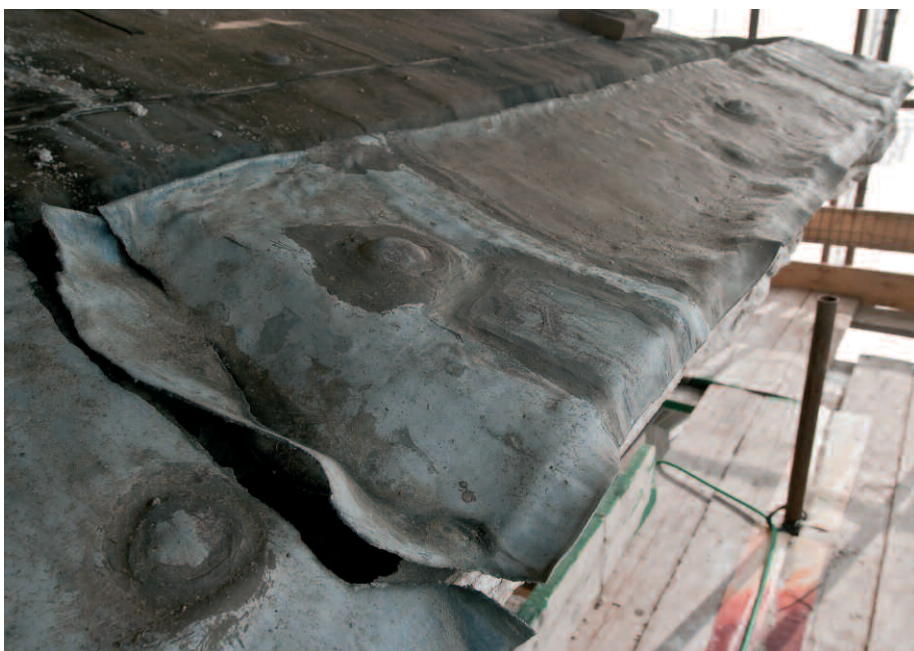
10. La coperta in piombo del cornicione sotto la balaustra sommitale, prima del restauro.
