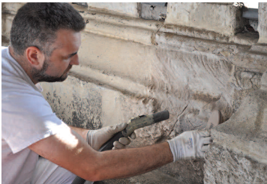
3. Pulitura per aspirazione. Sono evidenti le striature dovute ai diversi gradi di intensità di corrosione della superficie lapidea.
